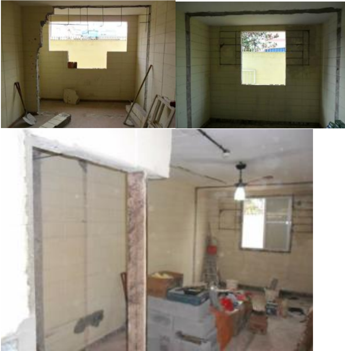
Retirada de parede da área dos apartamentos do pavimento térreo e Ampliação do banheiro, aproveitando espaço do armário do quarto.
